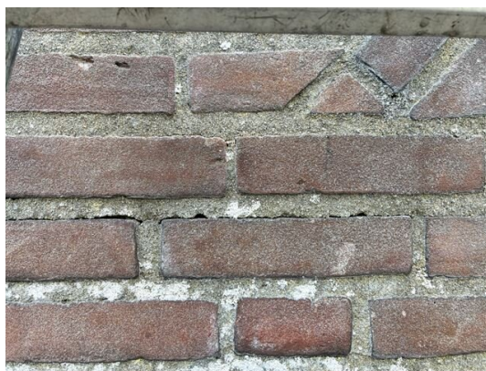
gevel no. 2: gaterige mortel topgevel (2025)
