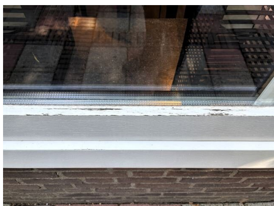
gevel no. 4: verf gebladderd (2025)
