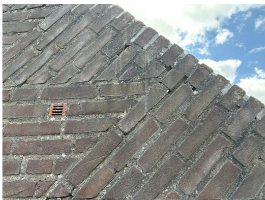
gevel no. 2: weggefallen voegwerk onder rollraag (2025)
