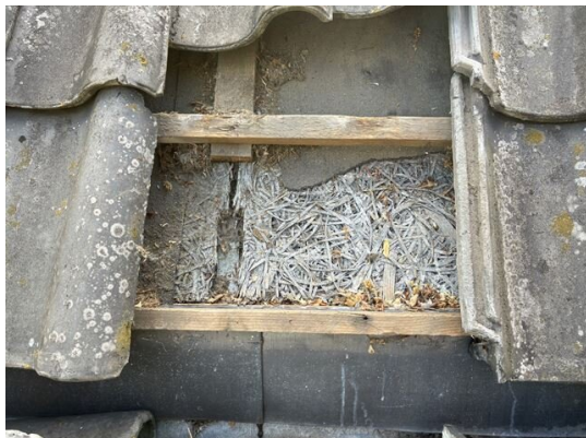
algemeen: bitumen onder dakpannen beschadigd en vernageling roestig (2025)
