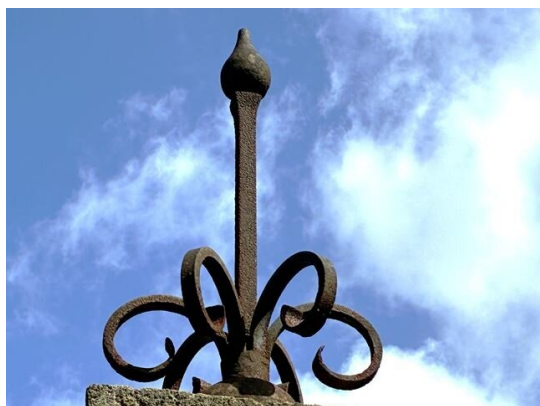
gevel no. 1: smeedwerk roestig (2025)
