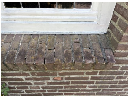
gevel no. 1: uitgesleten voegwerk (2025)
