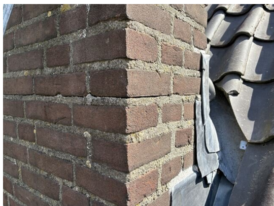
gevel no. 1: horizontale scheurvorming (2025)
