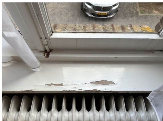
gevel no. 2: gebarsten en gebladderd binnenschilderwerk (2025)
