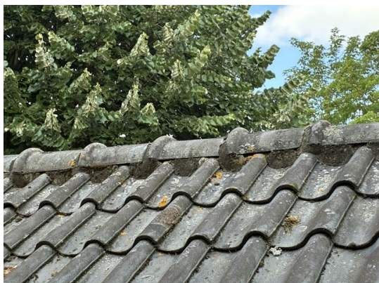
dak no. 8-10: speciezomen verweerd en plaatselijk losgekomen (2025)
