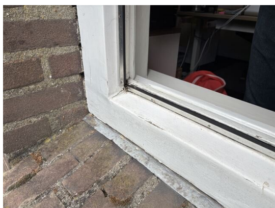
gevel no. 1: verf gebarsten (2025)
