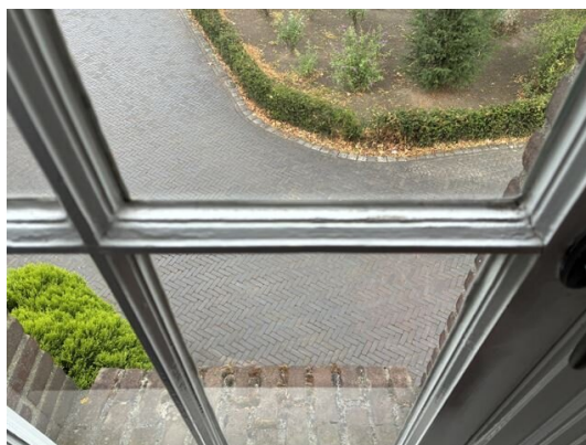
gevel no. 1: gebarsten en gebladderd binnenschilderwerk (2025)
