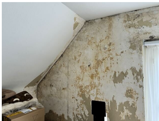
gevel no. 2: schimmelvorming (2025)
