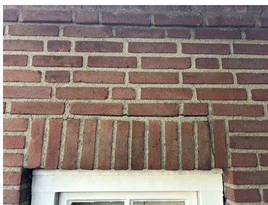
gevel no. 10: losgescheurde rollaag (2025)
