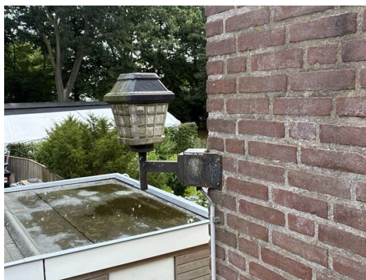
gevel no. 2: lantaarns roestig (2025)
