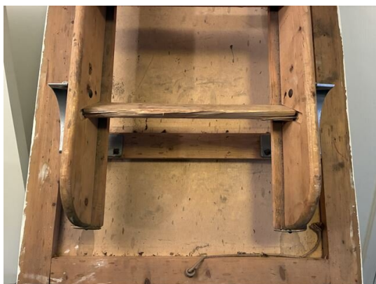
zolder: trede vlizotrap beschadigd (2025)
