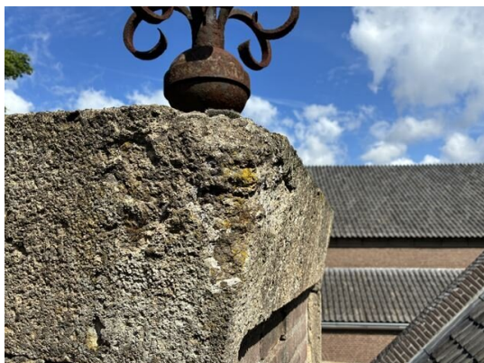
gevel no. 1: beschadigd element (2025)
