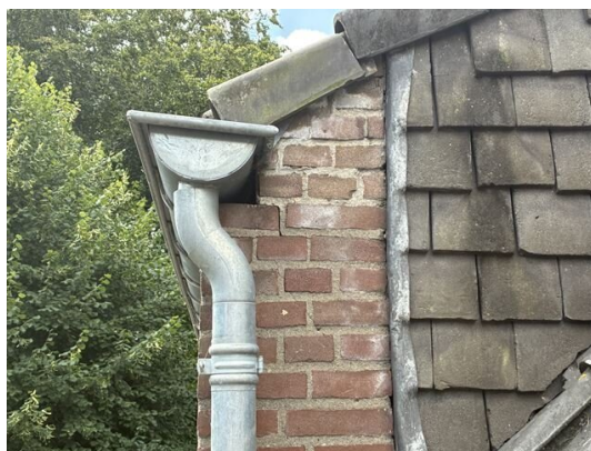
gevel no. 5: losgescheurd metselwerk (2025)
