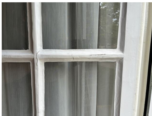
gevel no. 1: gescheurde stopverf (2025)
