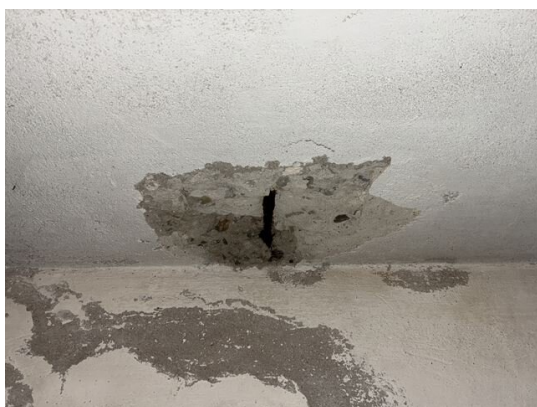
kelder: roestige betonwapening (2025)
