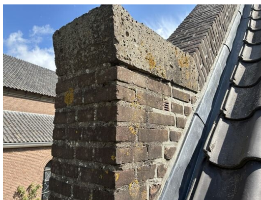
gevel no. 2: weggefallen voegwerk aanzet (2025)
