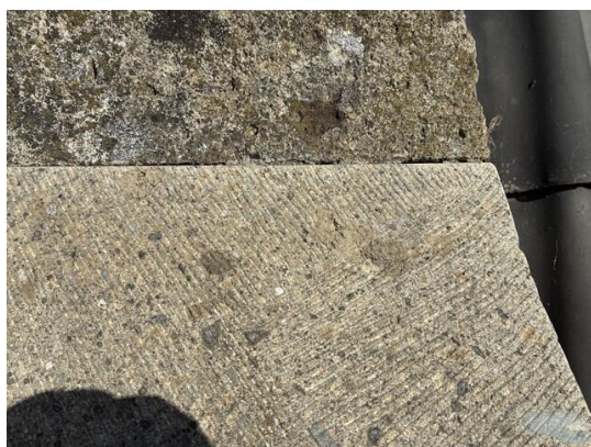
gevel no. 1: open voegwerk tussen natuurstenen elementen, waardoor inwatering (2025)
