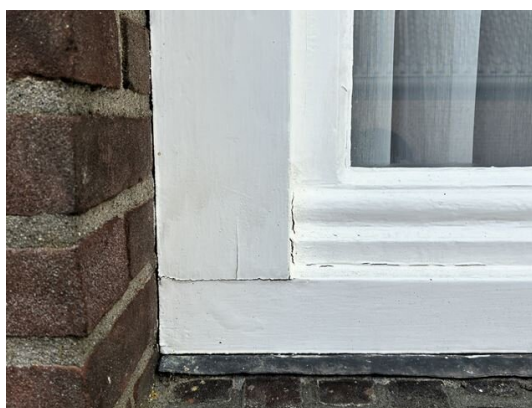
gevel no. 2: verf op diverse plaatsen gebarsten (2025)
