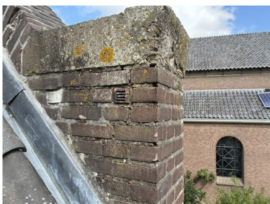
gevel no. 2: weggefallen voegwerk aanzet (2025)
