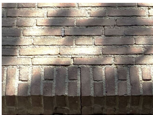
gevel no. 4: gescheurde rollaag (2025)
