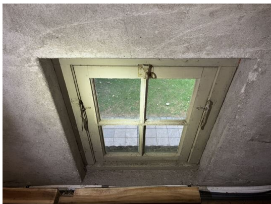
gevel no. 13: buitenraamkozijn staat enigszins los in spouw (2025)
