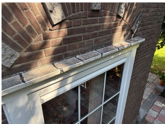
gevel no. 4: gevellood gescheurd en tijdelijk met kit gedicht (2025)
