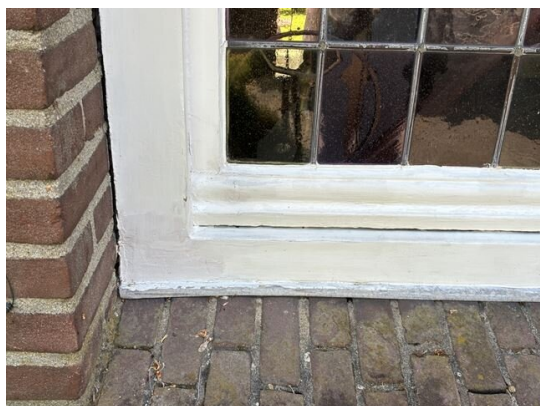
gevel no. 1: dekking onvoldoende (2025)
