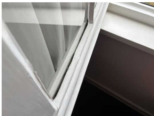
gevel no. 1: stopverf losgekomen van glas (2025)
