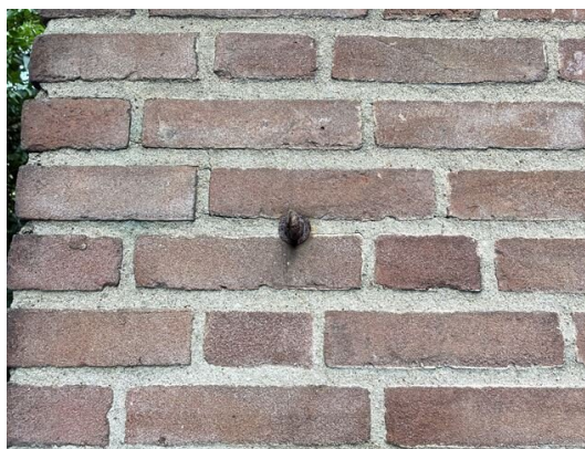
gevel no. 9: roestig bevestigingsmiddel (2025)
