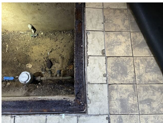
gang begane grond: meterputomranding zeer roestig (2025)
