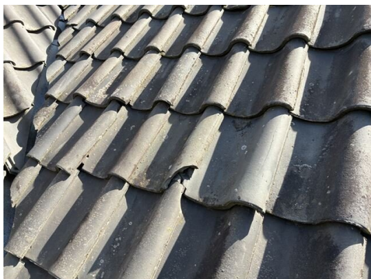
dak no. 1: diverse beschadigde dakpannen (2025)
