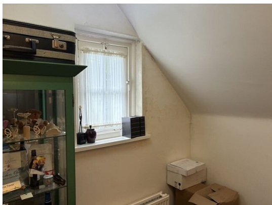
gevel no. 4: binnenpleisterwerk beschadigd door vocht (2025)
