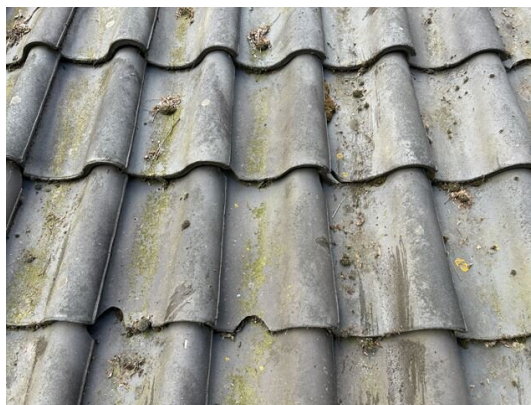
dak no. 10: diverse beschadigde dakpannen (2025)
